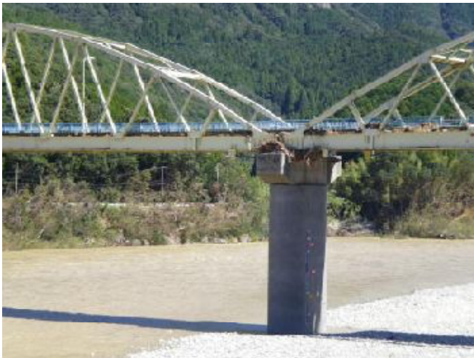
熊野川に架かる橋ゲタや通路に流木
